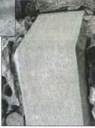
Pilier sud Intérieur, en haut Extérieur, en bas
